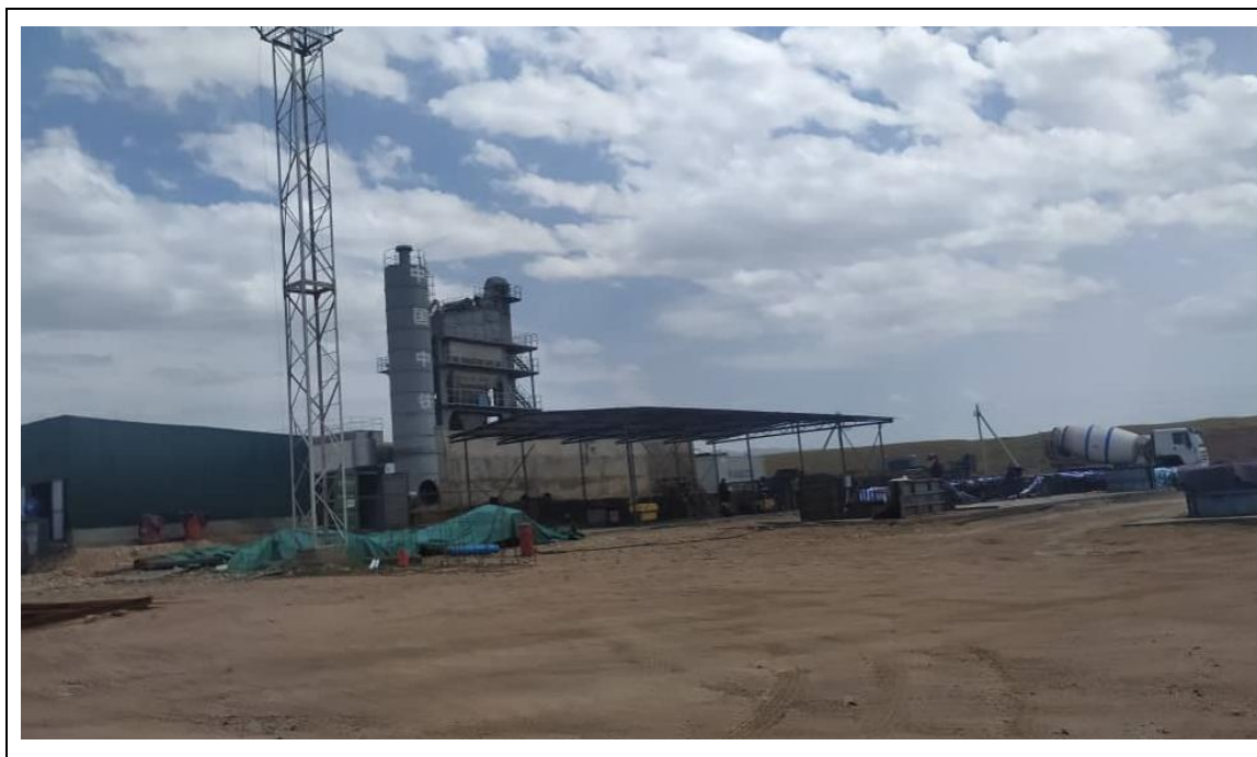
Рисунок 10 АБЗ на территории производственной площадки
